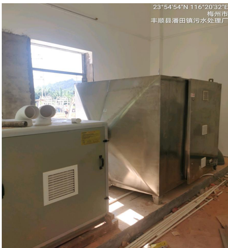
废气处理设施
